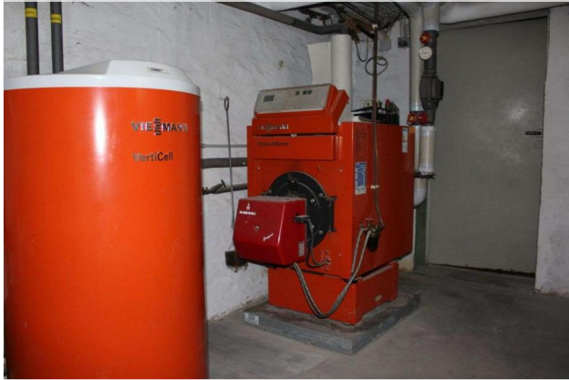
Heizung mit Warwasserspeicher
